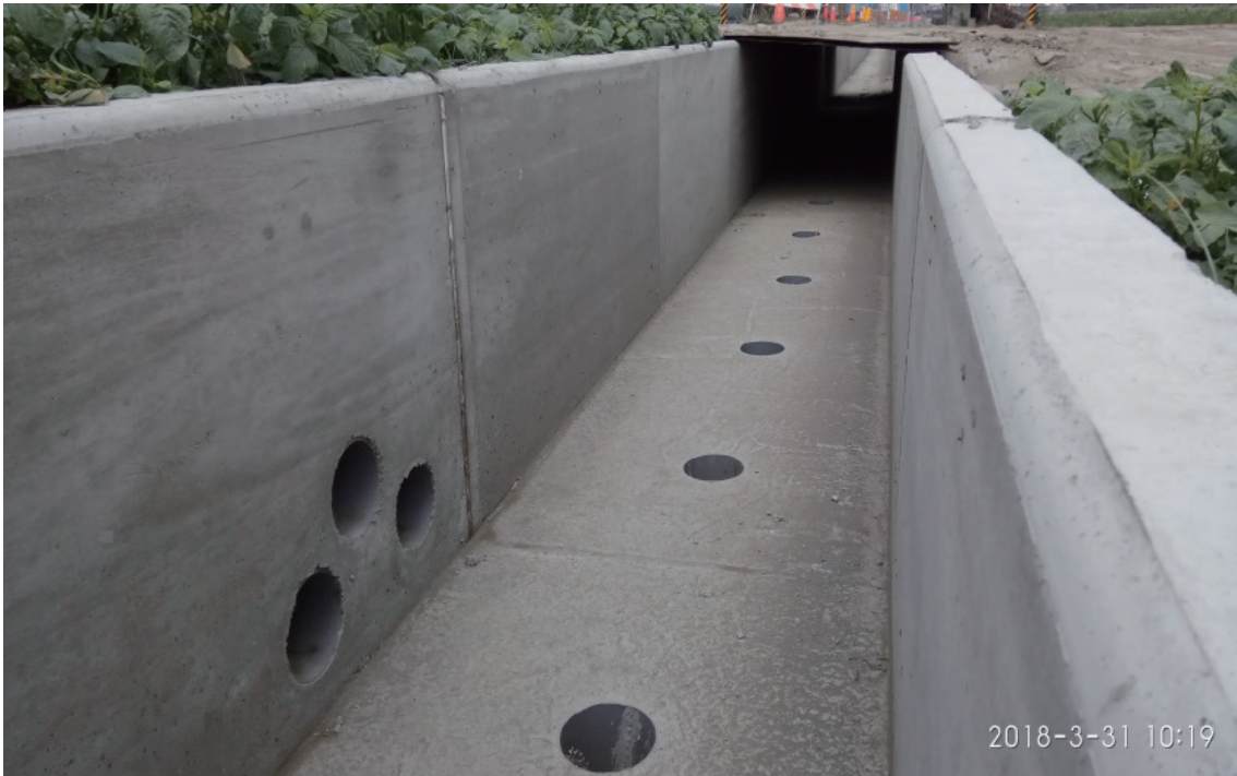
雲林縣麥寮鄉麥寮（一）農地重劃區 - 小排水路滲水及生態孔設施
